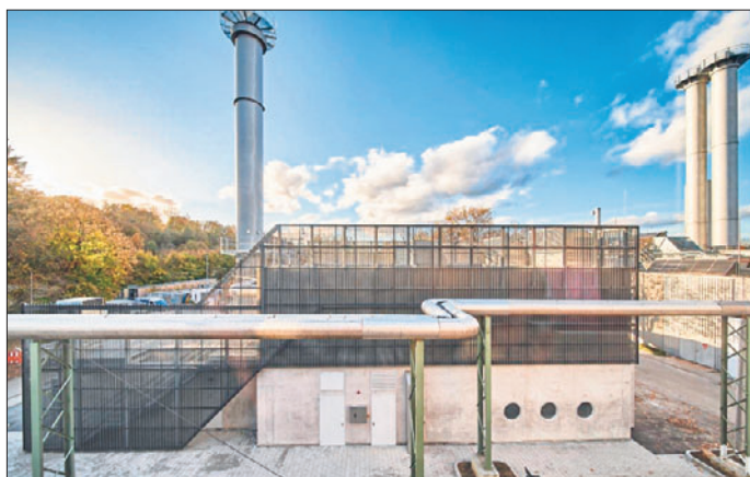
Das BHKW in der Hauffstraße.
