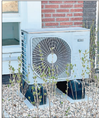
Die KlimaschutzAgentur informiert über modernes Heizen wie hier mit einer Wärmepumpe.
